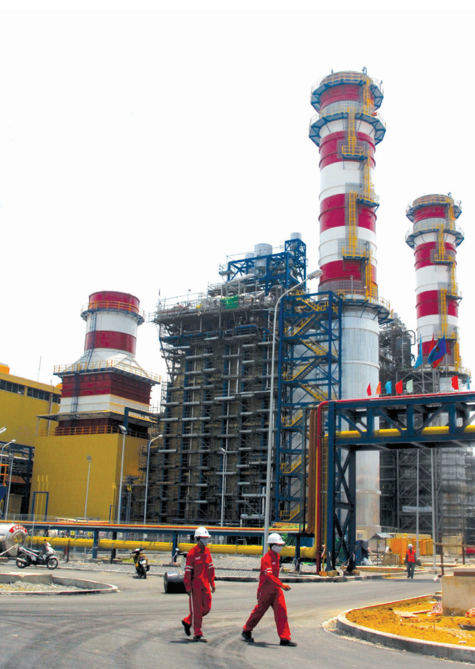
Nhà máy Điện Nhơn Trạch 2
