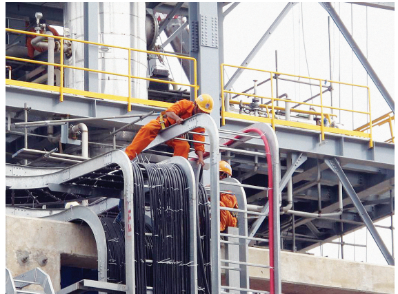
Nhà máy Lọc dầu Dung Quất
