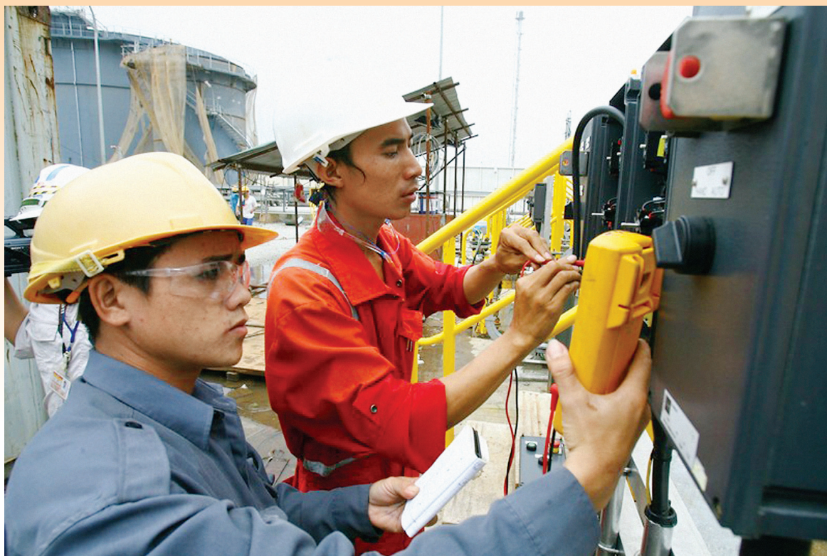
Kỹ sư kiểm tra thiết bị đầu nối
